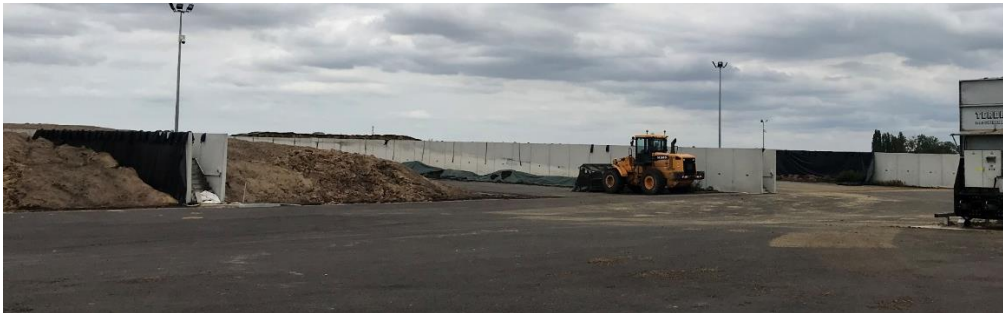
Figure 4 : Etat des dalles de stockage lors de la campagne
